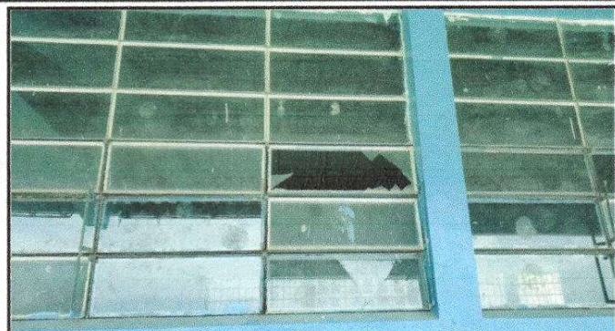
Foto1: Sustrucción de vidrios.
